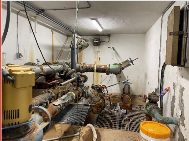
Pumproom Cuarto de bombeo
