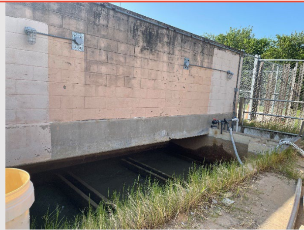
Filtration System Sistema de filtración
