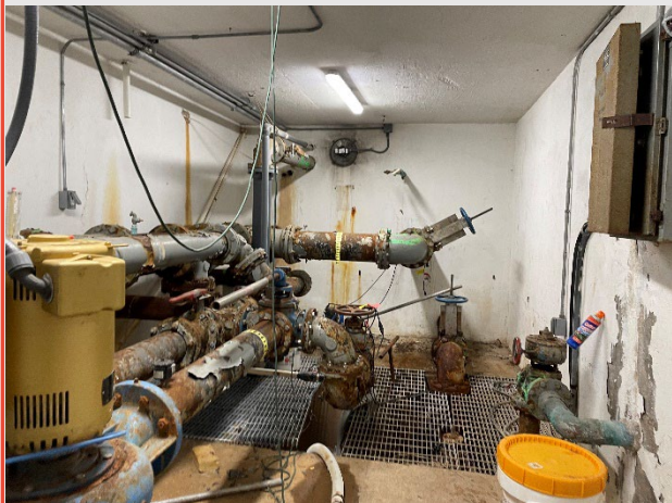
Pumproom Cuarto de bombeo
