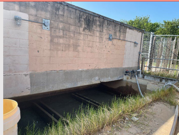
Filtration System Sistema de filtración
