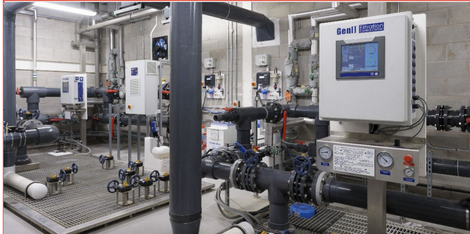
Mechanical Systems Sistemas mecánicos
