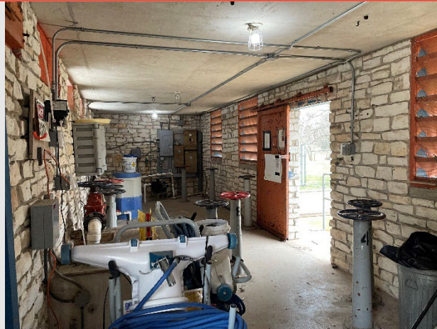
Chemical Room Cuarto de químicos
